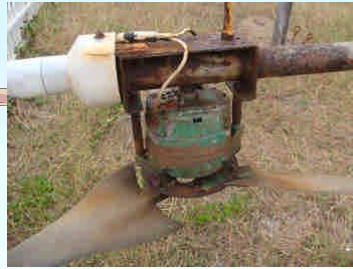
發電機鏽蝕、鹽蝕短路
